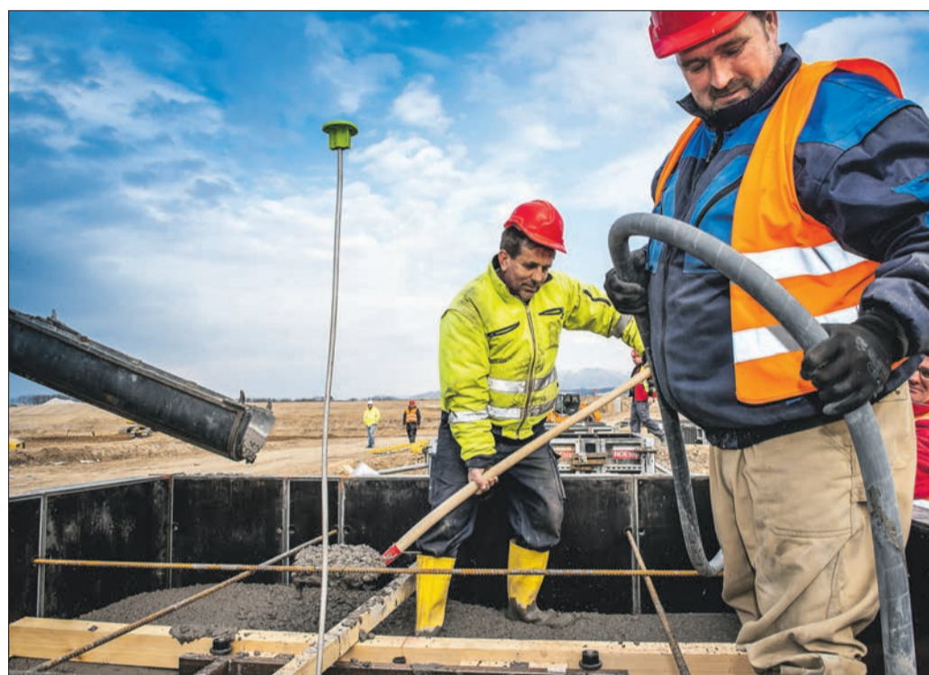
Beton, Marsch! Erste Arbeiten an den Fundamenten der Tribünen laufen. (Foto: K. Polkowski)
