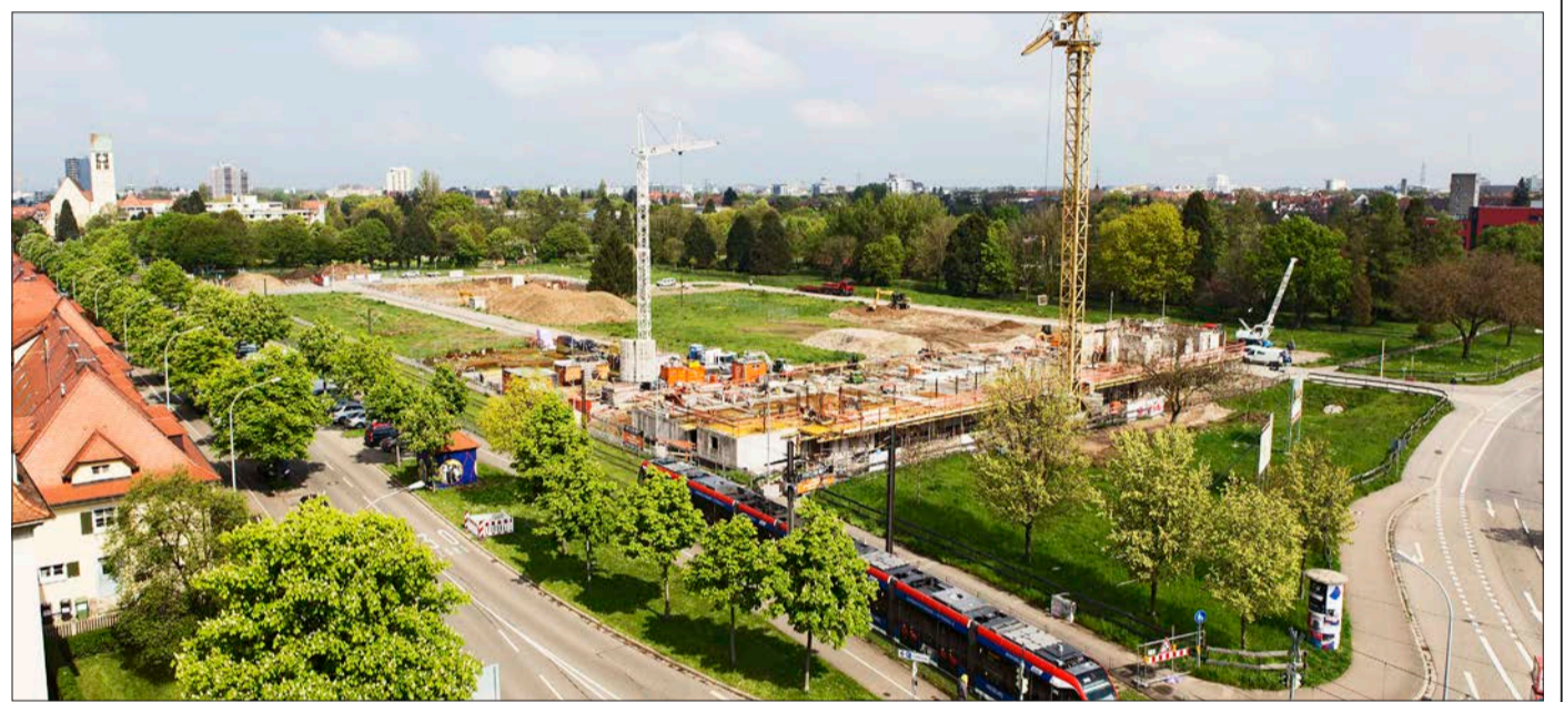
Kräne künden von den ersten Rohbauarbeiten in den Gutleutmatten. Links im Hintergrund neben der Haslacher St. Michael Kirche ist die Staudinger-Schule erkennbar, deren Blockheizkraftwerk die Wärmeversorgung des Wohnquartiers sichern soll. (Foto: A. J. Schmidt)
