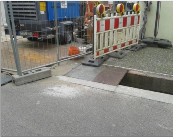
Abbildung 2: Zu schmaler Übergang über Bächele. Freiburg, Herrenstraße, Juni 2016 (Quelle: eigenes Foto)
