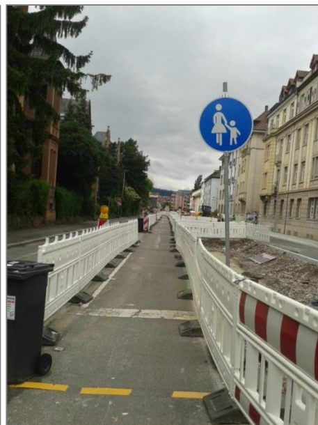
Abbildung 7: Notweg bei großer und wandernder Baustelle, wenig kontrastreich. Freiburg, Kronenstraße, Juni 2016 (Quelle: eigenes Foto)
