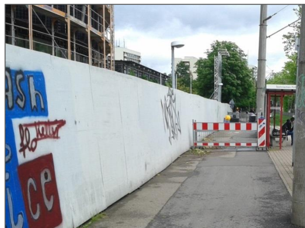
Abbildung 11: Bauzaun mit Holzabsperzung, gute Querabsperzung inkl. Tastleiste. Freiburg, Technisches Rathaus, Juni 2016 (Quelle: eigenes Foto)
