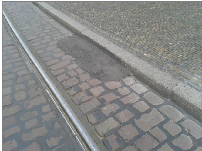
Abbildung 15: Unzureichender Rolli-Keil. Freiburg, Oberlinden, Juni 2016 (Quelle: eigenes Foto)
