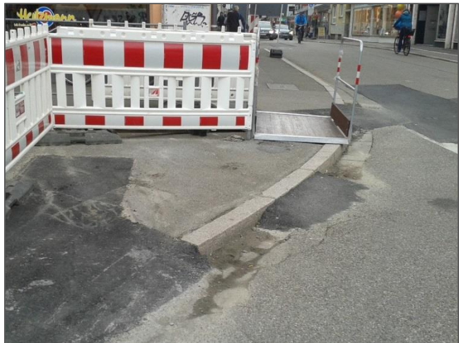
Abbildung 17: Grabenbrücke ohne ausreichende Bewegungsfläche vor der Brücke. Freiburg, Friedrichring, Juni 2016 (Quelle: eigenes Foto)
