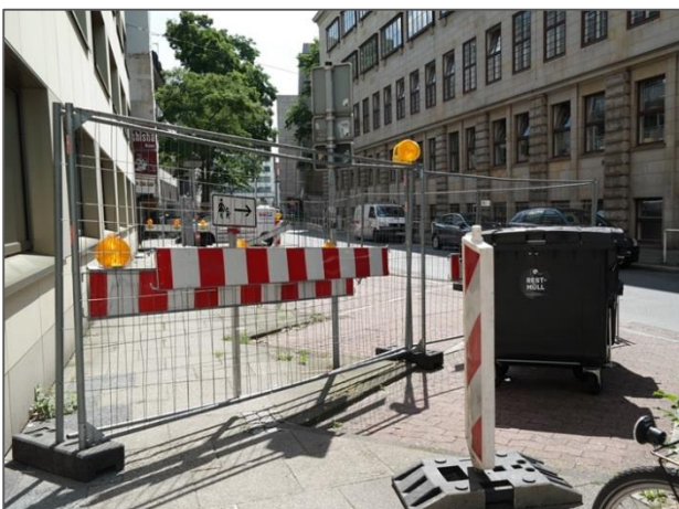
Abbildung 10: mit Absperrschranke ergänzter Bauzaun, Bremen, 2016 (Quelle: eigenes Foto)
