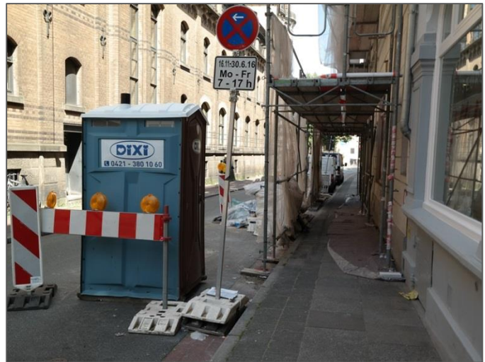
Abbildung 21: Schlecht gesichertes Durchlaufgerüst. Bremen, 2016 (Quelle: eigenes Foto)
