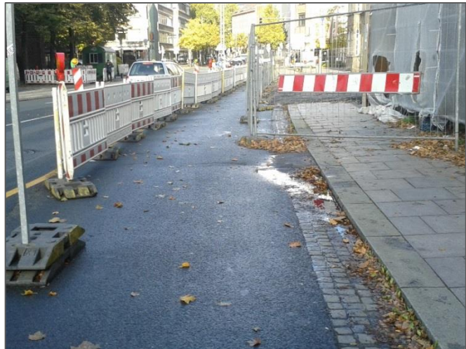
Abbildung 9: Absperrschranken zur Fahrbahn sind abwechselnd zum Notweg und zur Fahrbahn orientiert. Bremen, 2016 (Quelle: eigenes Foto)
