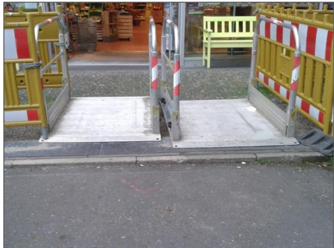
Abbildung 18: Zwei nebeneinander liegende Grabenbrücken. Die Kante davor müsste angerammt werden. Freiburg, Fahnenbergplatz, Juni 2016 (Quelle: eigenes Foto)
