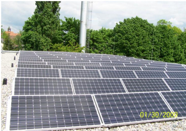
Abb. 31: PV-Anlage auf dem Dach des ehemaligen Thermalbades Zähringen
